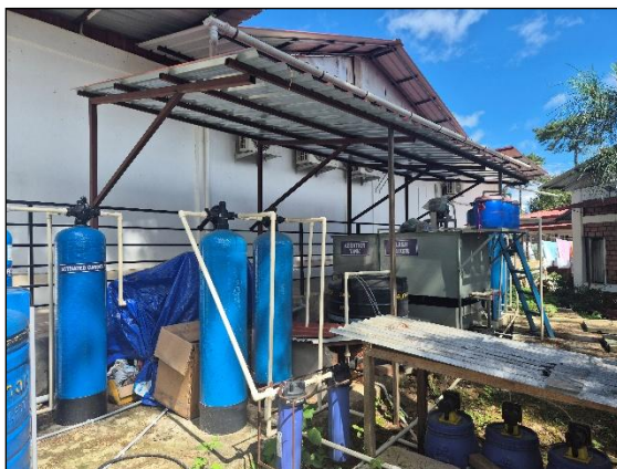
Fig. Effluent Treatment Plant (ETP)
